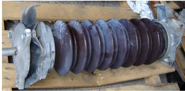
Figura 4-9 – Descarregador de subestação após um defeito interno ter actuado o dispositivo de alívio de sobrepressão
