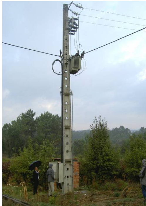
Figura 8-2 – Posto de transformação aéreo
