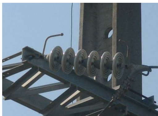
b) Haste de guarda fixa instalada em cadeia de isoladores de uma linha aérea
