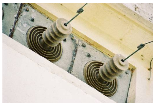
Figura 8-9 – Isoladores de travessia (vulgo, passa-muros) em resina epóxida
