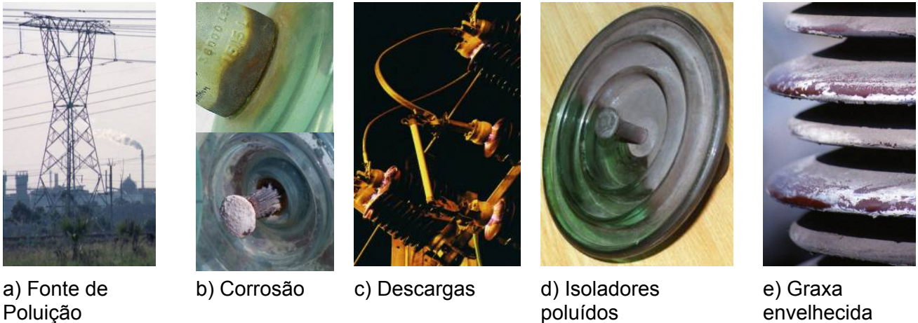
Figura 6-1 – Evidência típica de problemas relacionados com a poluição
